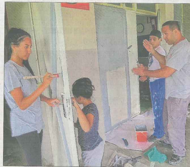
Plusieurs jeunes ont participé à la réfection des vestiaires du gymnase Silvano (quartier de la Monnaie) pendant l'été 2017, dans le cadre des chantiers éducatifs. Photo LeDL/Archives Floriane LIONNET
